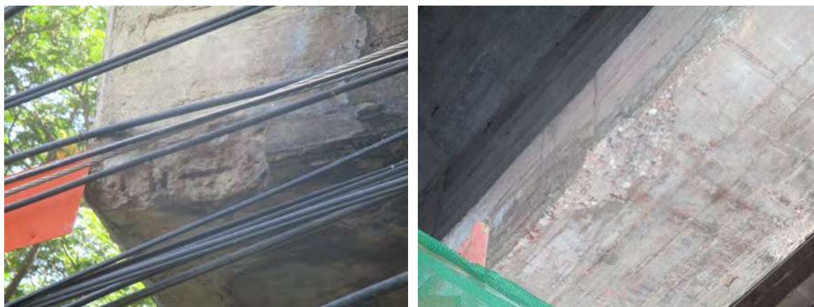
รูปที่ 2-7 ตัวอย่างภาพความเสียหายของสะพาน
