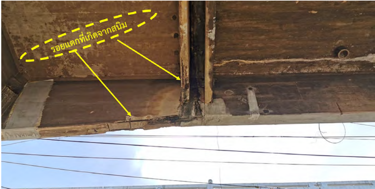
รูปที่ 9-13 รูปที่ 3-6 สนิมที่เกิดขึ้นที่เหล็กเสริมและทำให้คอนกรีตกะเทาะ
